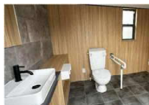
トレーラー内トイレ
