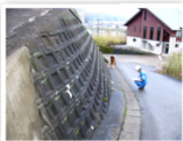
①被害状況確認（擁壁）
