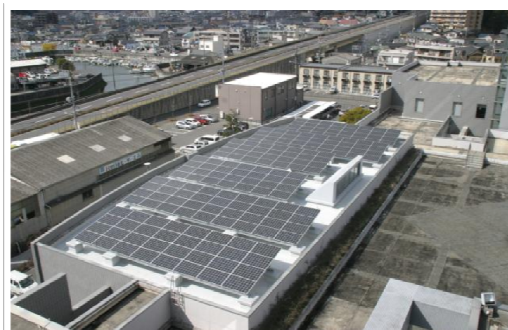
廿日市市庁舎 太陽光発電システム全景
