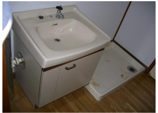
洗面台・洗濯パン
