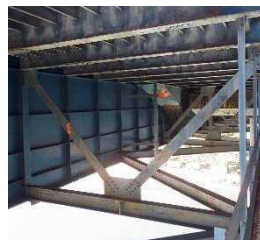
上部工の塗装劣化
