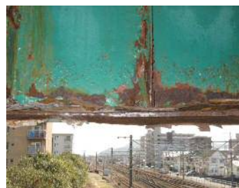
主桁の塗装劣化
