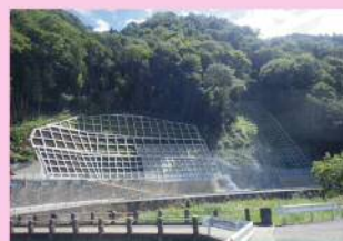
【法面对策】 (主) 府中上下線 久佐工区 (府中市阿字町) 【R2 完成】
