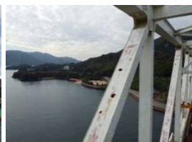
上部工の塗装劣化
