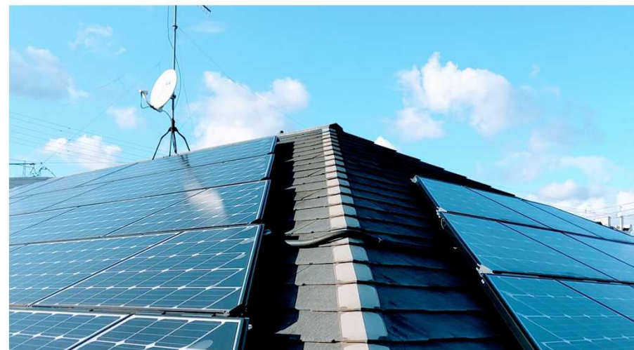
屋根に設置された太陽光パネル
