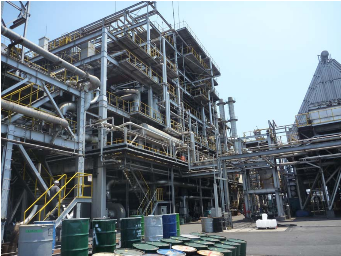
溶融炉を含む焼却炉全体 (焼却炉内部に溶融炉が組み込まれている)
