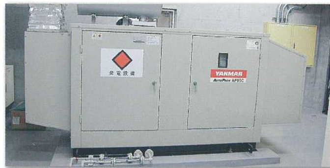
予備発電設備
