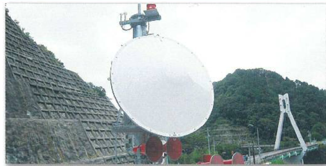
多重無線アンテナ
