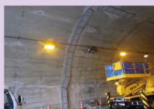
【トンネル補修】 国道184号 木門田トンネル (尾道市木ノ庄町) 【R2 完了】
