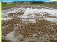
地面の凹凸で水たまりが発生
