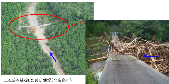
土石流を捕捉した砂防堰堤(北広島町)
