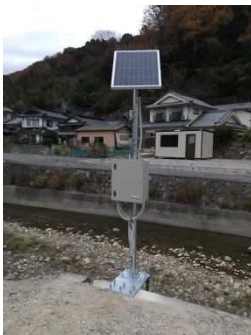
【簡易型河川監視カメラ設置例】
