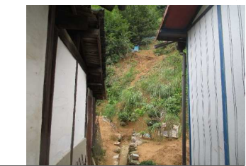
斜面崩壊・被災状況（H30年7月）
