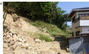
斜面崩壊・被災状況（H30年7月）
