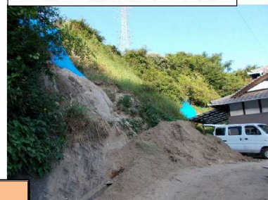
斜面崩壊・被災状況（H30年7月）
