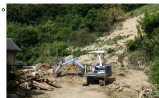
斜面崩壊・被災状況（H30年7月）
