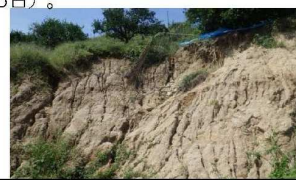
斜面崩壊・被災状況（H30年7月）
