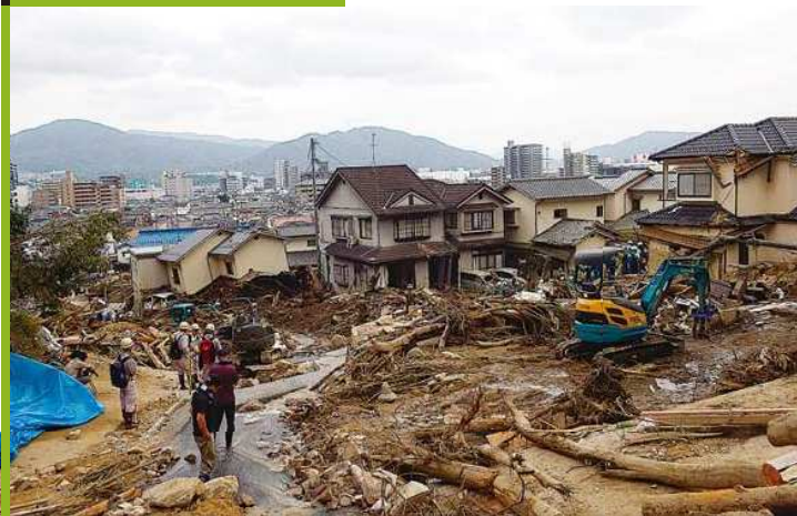
土砂の流出状況
