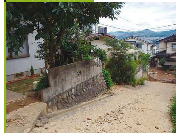
土砂の流出状況
