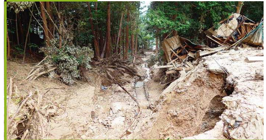
溪流の荒廃状況
