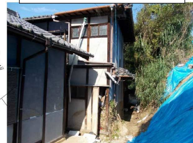
斜面崩壊・被災状況（H30年7月）
