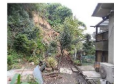
斜面崩壊・被災状況（平成30年7月）
