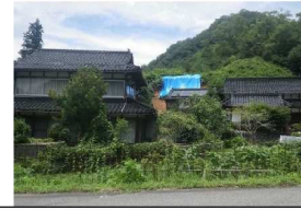
斜面崩壊・被災状況（H30年7月）
