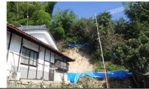
斜面崩壊・被災状況（H30年7月）
