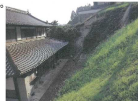
斜面崩壊・被災状況（平成30年8月）
