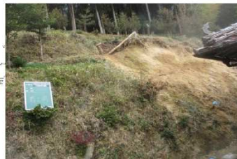
斜面崩壊・被災状況（H30年7月）
