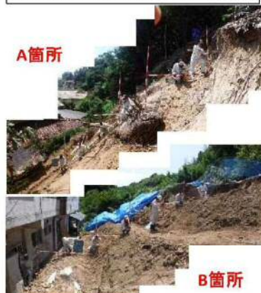
斜面崩壊・被災状況（H30年7月）
