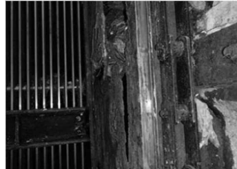
処理場機械 腐食状況
