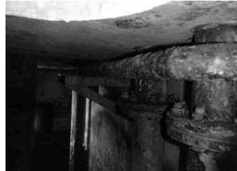
処理場内配管 腐食状況
