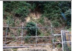
斜面崩壊・被災状況（H30年7月）
