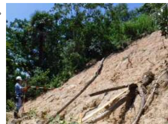
斜面崩壊・被災状況（H30年7月）
