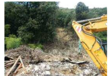
斜面崩壊・被災状況（H30年7月）
