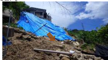
斜面崩壊・被災状況（H30年7月）
