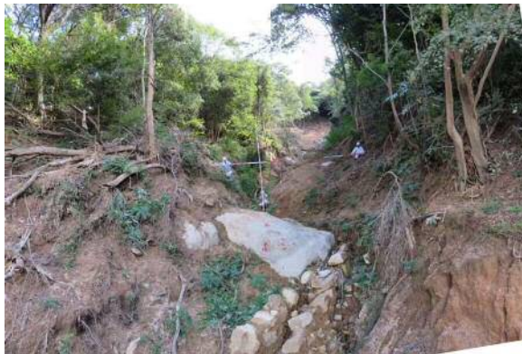
【工事前の荒廃状況】
