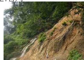
斜面崩壊・被災状況（H30年7月）
