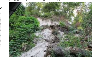
斜面崩壊・被災状況（H30年7月）
