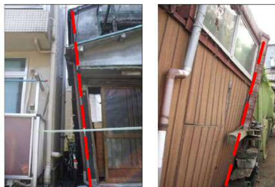
柱の変形が著しく倒壊の危険がある家屋 (特定空き家)
