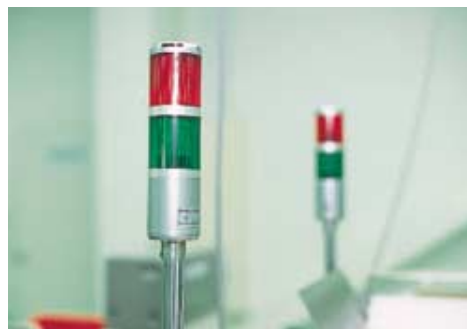
非常ランプ。不適格品の発生時、製品や袋が可動部にはさまった時、コンベアの停止時などに点灯し、異常を知らせます。聴覚障害者などにも対応できる設備となっています
