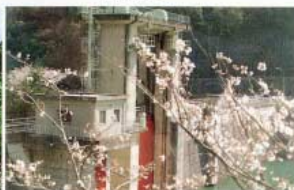
▲ 取水塔・放流ゲート・量水塔設備
