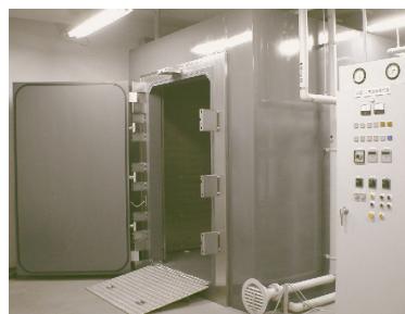
県立文書館の燻蒸施設。臭化メチル用に設計されているため、このままでは他の薬剤に対応できない。
