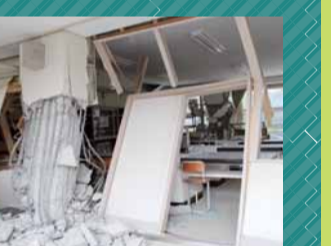
東日本大震災被害例(福島県本宮市) 地震に耐える学校建物に
