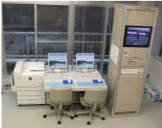
ダム管理用制御処理設備
