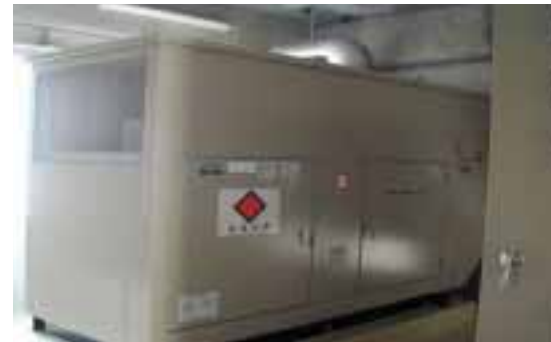
予備発電設備
