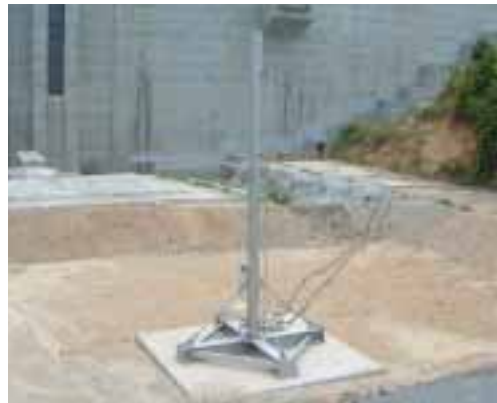
曝気設備 (湛水前)
