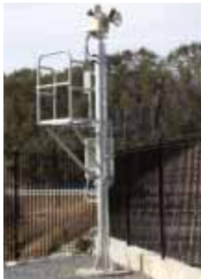
CCTVカメラ装置
