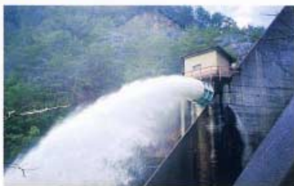
▲ハウエルバンガーバルブ 発電停止の際に維持用水の補給のため放流する設備
