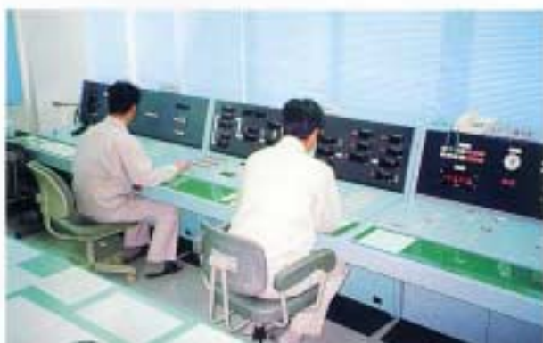
▲操作室 ダム管理に必要な情報データ処理は全て操作室に集められコンピュータによりゲート・バルブの遠隔操作も可能
