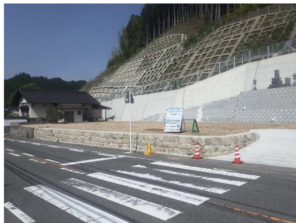
急傾斜地崩壊対策事業 檜原地区 （廿日市市玖島） 令和3年度完成
