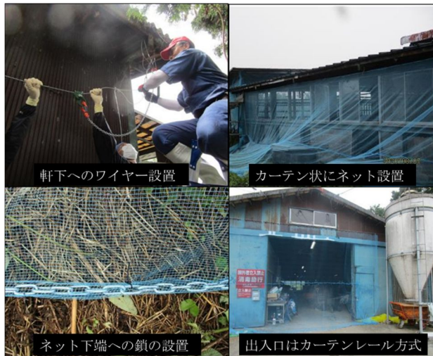
図3 防虫ネット設置状況(令和2年度)
