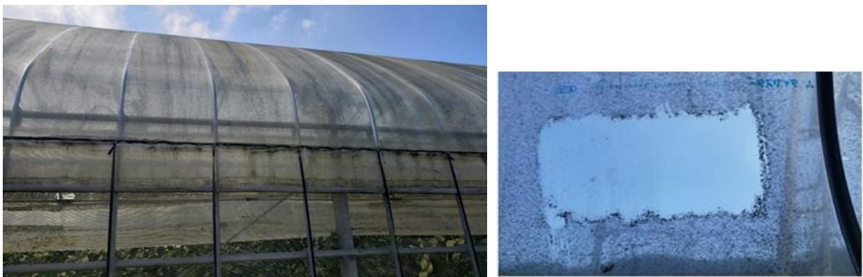
図2 現地で多発する付着生物によるフィルムの汚れの状況 左：外観、右：布でこすり落とした状態
