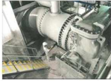
雨水ポンプの整備
