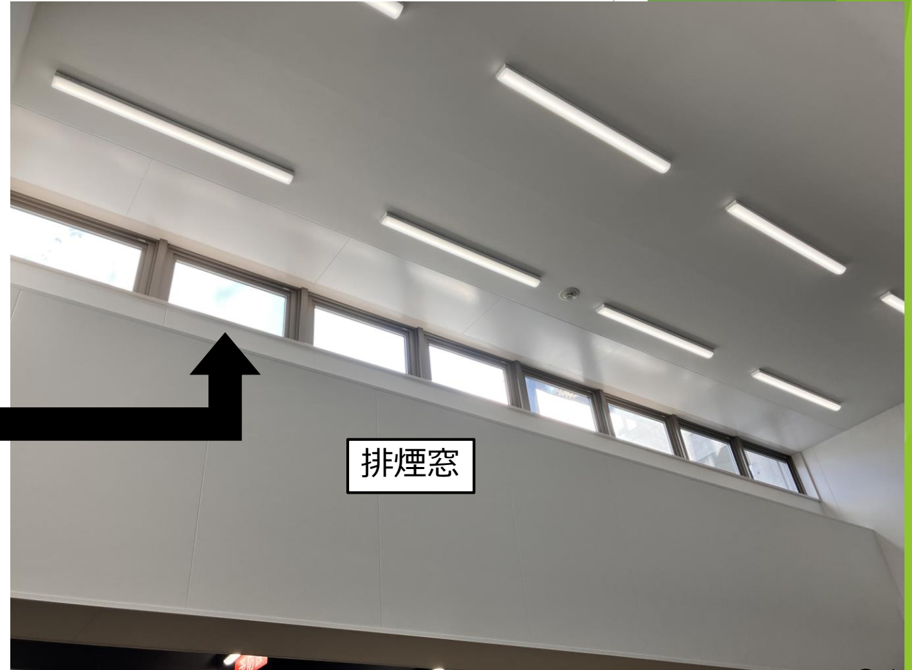
排煙オペレーター
