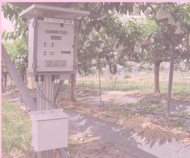
図3 モモ園に設置した樹液流速計測システム本体
