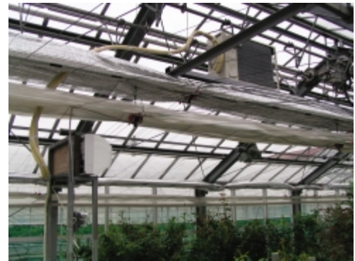
図 1 設置した家庭用ヒートポンプ
