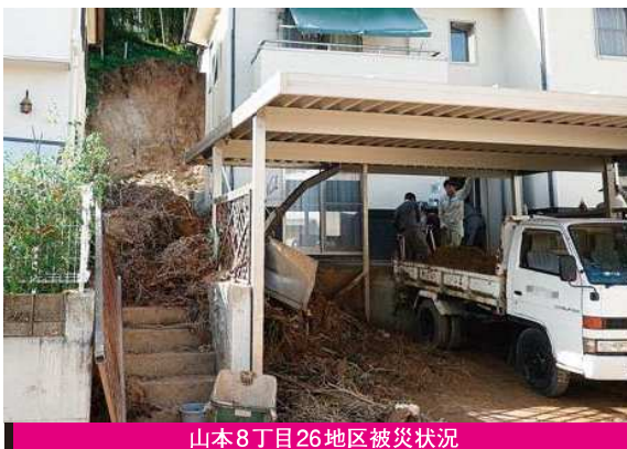
山本8丁目26地区被災状況
