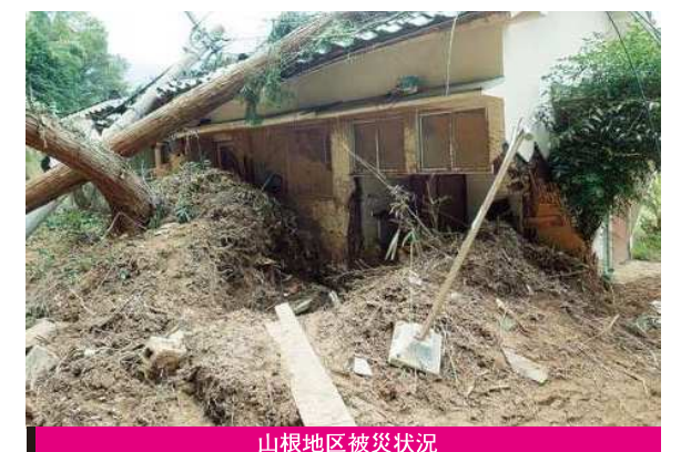
山根地区被災状況
