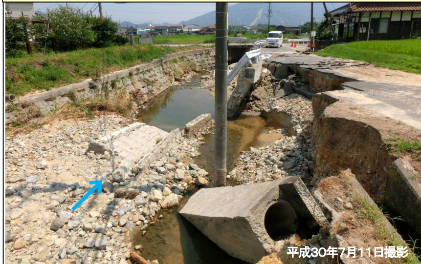
豪雨により神洗川が氾濫 護岸が流失
