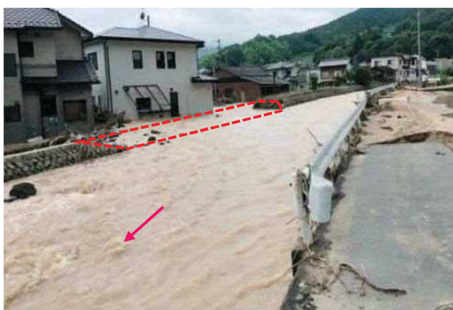
河川の破堤状況(野呂川水系中畑川)
