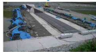
ゴム堰が倒れた状態
