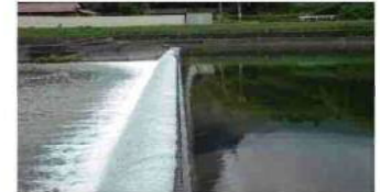
ゴム堰が起立した状態
