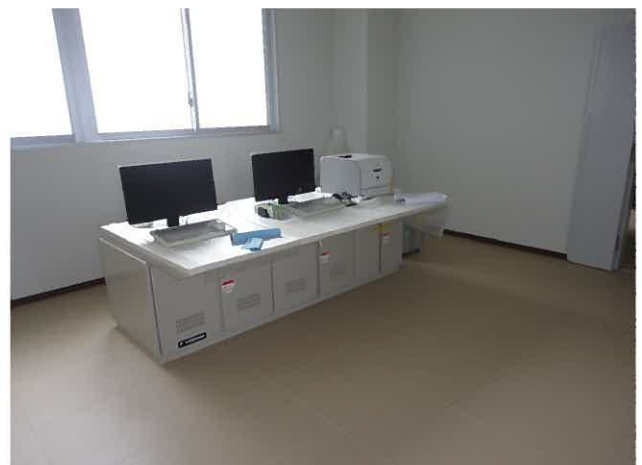
中央監視室(LCD監視操作装置)
