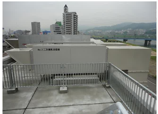
自家発電装置消音器
