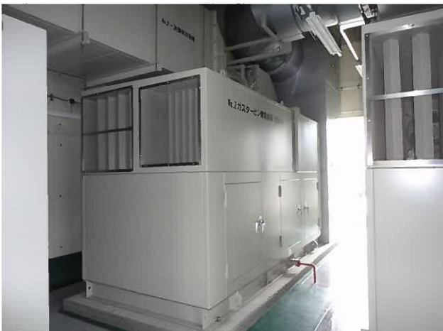
ガスタービン自家発電装置
