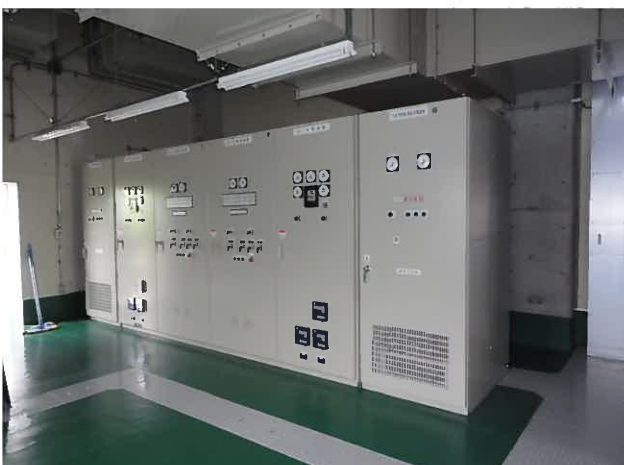
自家発電装置制御盤
