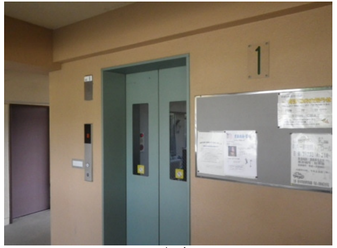
エレベーター
