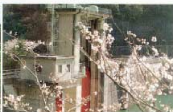
▲ 取水塔・放流ゲート・量水塔設備
